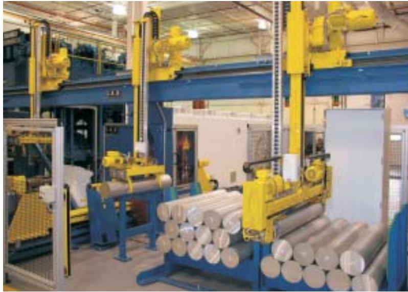
Bild 5: Umrichtergespeiste 5 Zonen-Anlage mit 1250 kW und kompletter Fördertechnik
