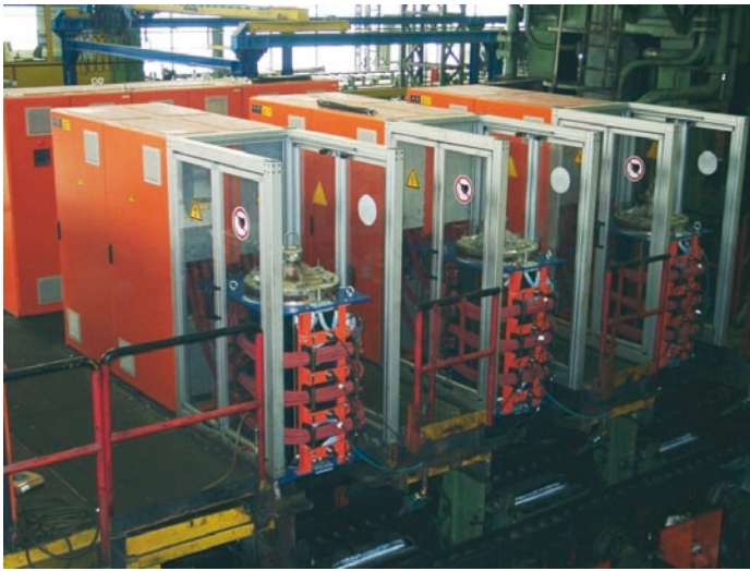
Bild 8: Vertikale Nacherwärmung mit drei Einblock-öfen
